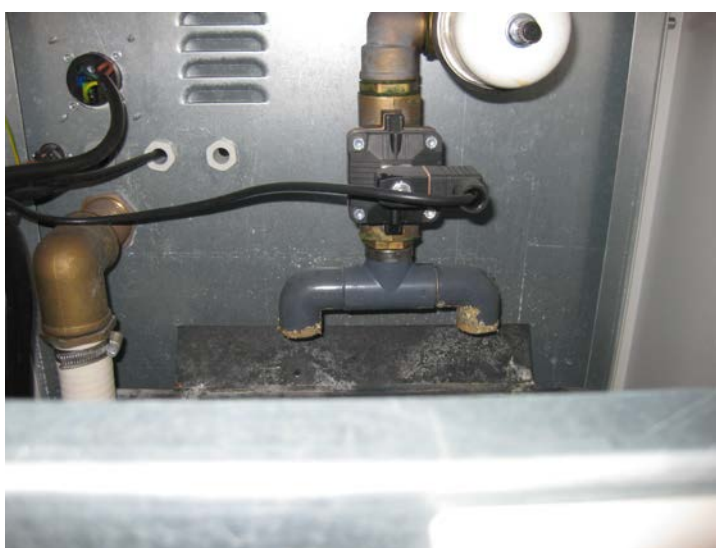
Figur 4 Efterfyldning via luftgab
