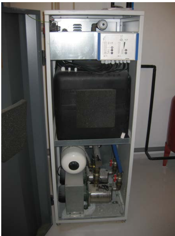
Figur 5 Styringsystemet i teknikrummet
